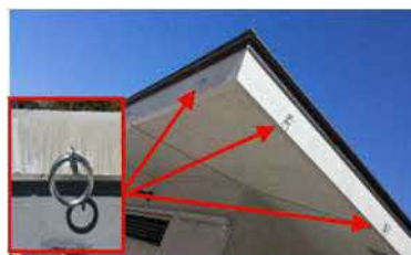
丸環（トイレ底先端）
